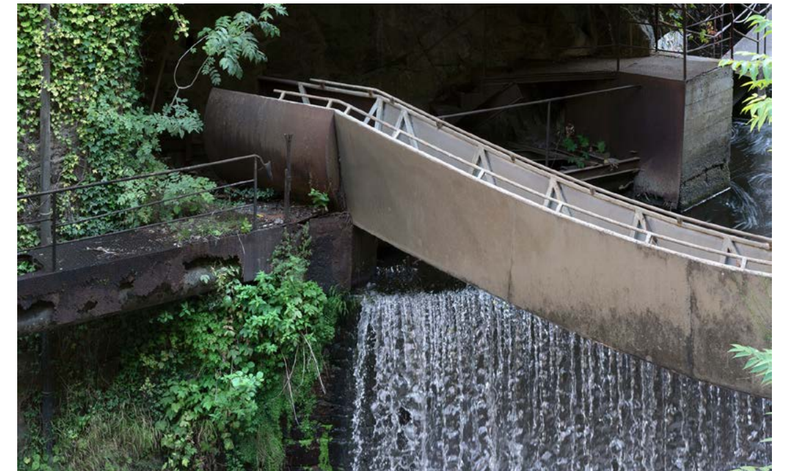
Etat dégradé du Pont de l’Épée (1988) et d’une portion des passerelles (1985-2001) de George Trakas au-dessus de la cascade du Creux de l’Enfer, 2021. © Vincent Blesbois
